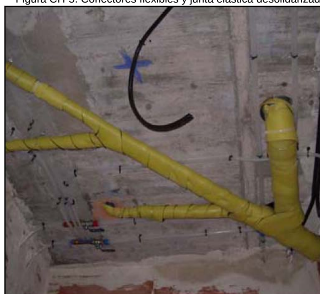
Figura CH-7. Aislamiento de pulpo de desagüe
