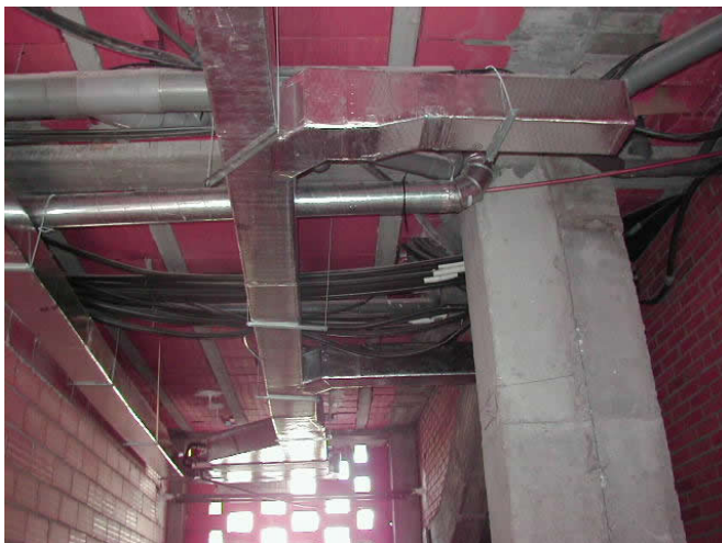
Figura CLI-03. Ejemplo de conductos de climatización
