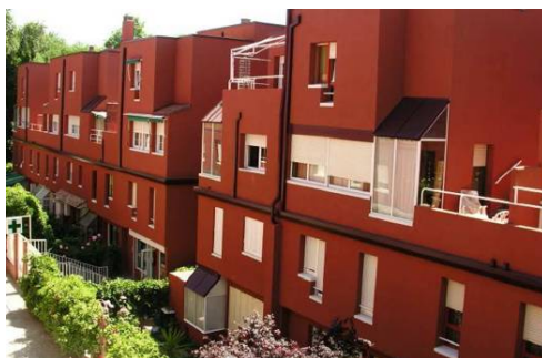
Fachada con SATE/ETIC
