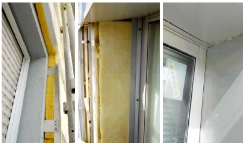
Figura 11. Mejora permeabilidad al aire por aislamiento exterior.
