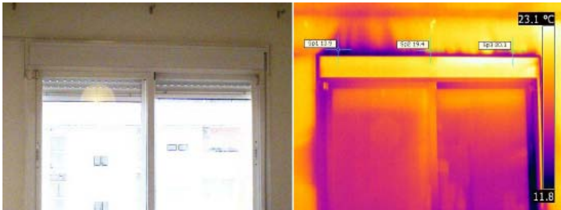
Figura 10. Análisis de filtraciones mediante imagen termográfica en ensayo de presurización/despresurización (Fuente: Proyecto Eficacia).
