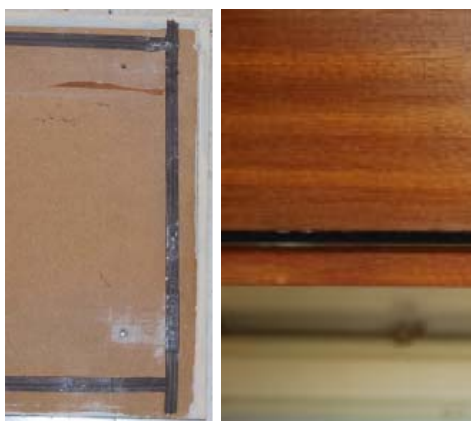
Figura 12. Mejora permeabilidad junta de cierre de tapa de registro de capitalzado.
