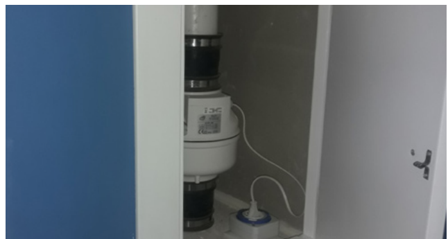
▼ Figura 8 - Extractor instalado en un armario de uso exclusivo
